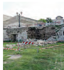
IL CROLLO Ecco le transenne
