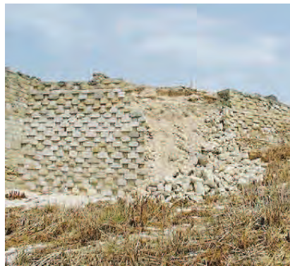
CANNE Le mura crollate. Finora nessun intervento
